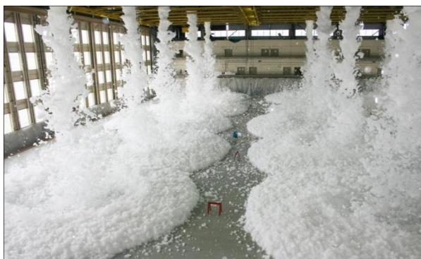
Рисунок 4 - Спринклерная установка пожаротушения
